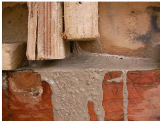
型枠からのモルタル分の流失
