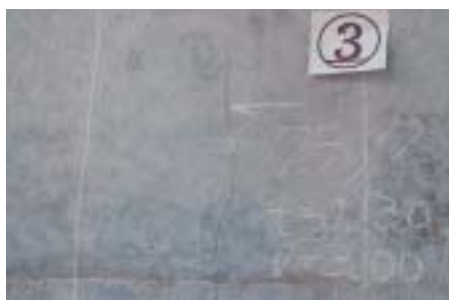
写真-2 ひび割れ
