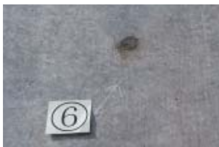
写真-3 沈下ひび割れ
