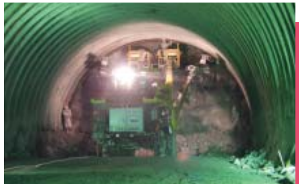
●主要県道益田阿武線(梅ノホトンネル)鋼製支保工建込(CII)
