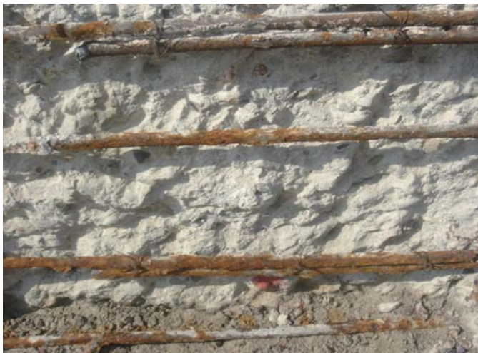
鉄筋腐食状況
