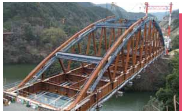
●一般国道491号 赤滝大橋(仮称) (ケーブルエレクション直吊工法)
